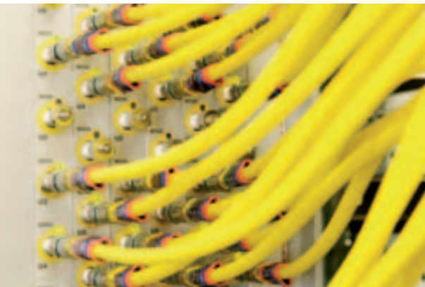
Moderne Kabel sichern den Zugang zu zahlreichen Multimedia-Angeboten
