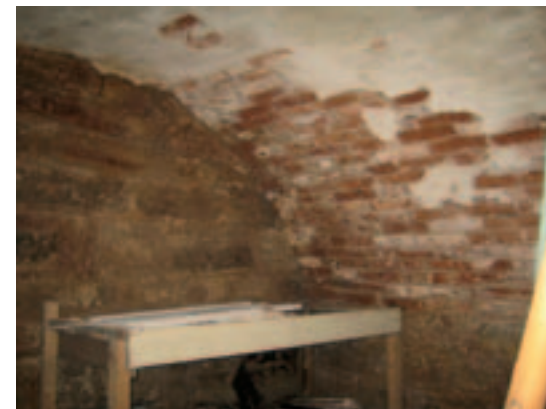
Putzschäden im Keller
